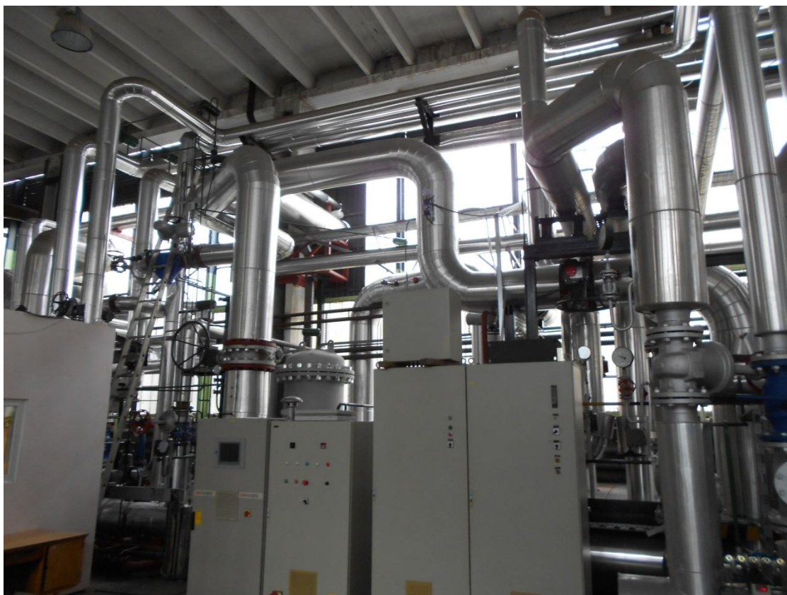
Osztó-gyűjtő sínek plc. vezérlése
