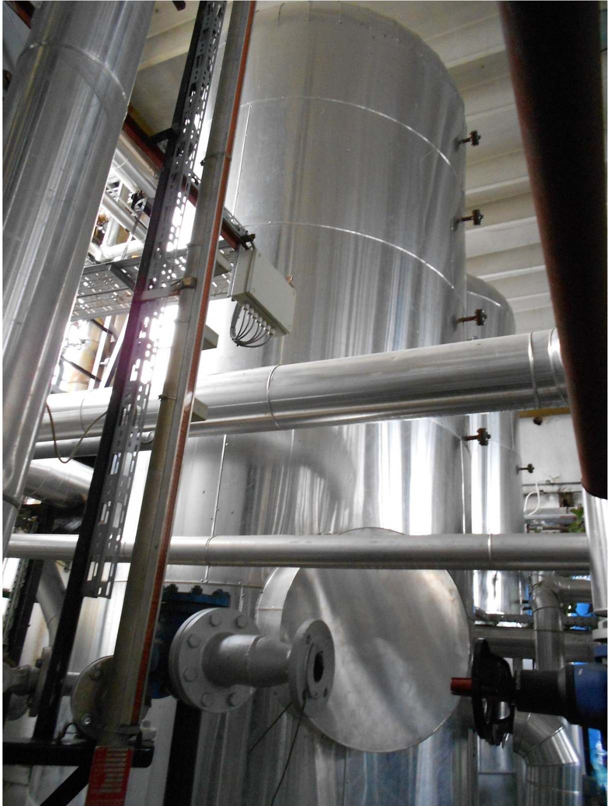
Kazánházi vezetékek elzárók
