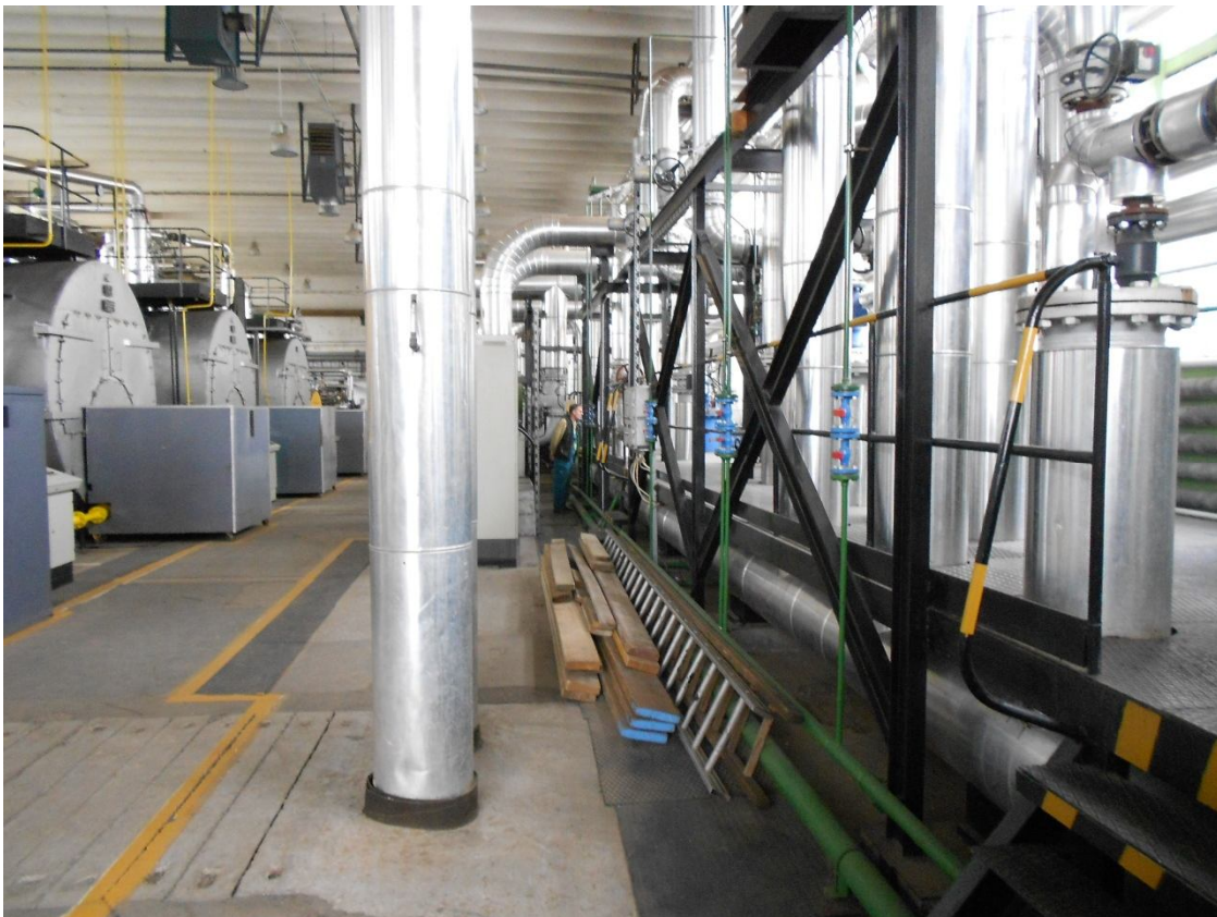
Kazánház sínrendszer és kazánok
